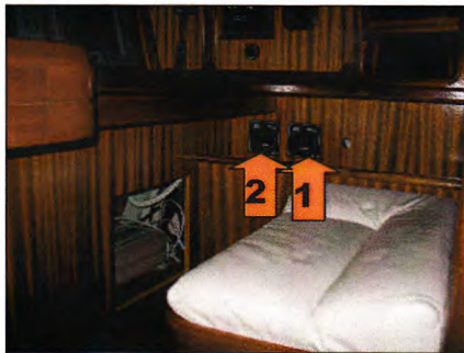
30. 12 Volt Hauptschalter (1), Hauptschalter für Bugstrahlruder (2)
